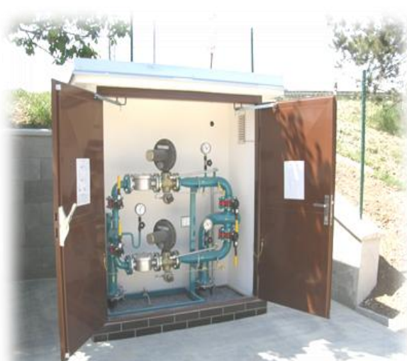
RZTD 3 v prefabrikovaném objektu
